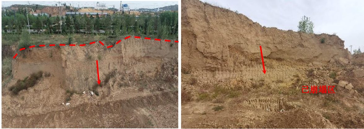
照片 4-5 BT5崩塌隐患（镜向28°）
