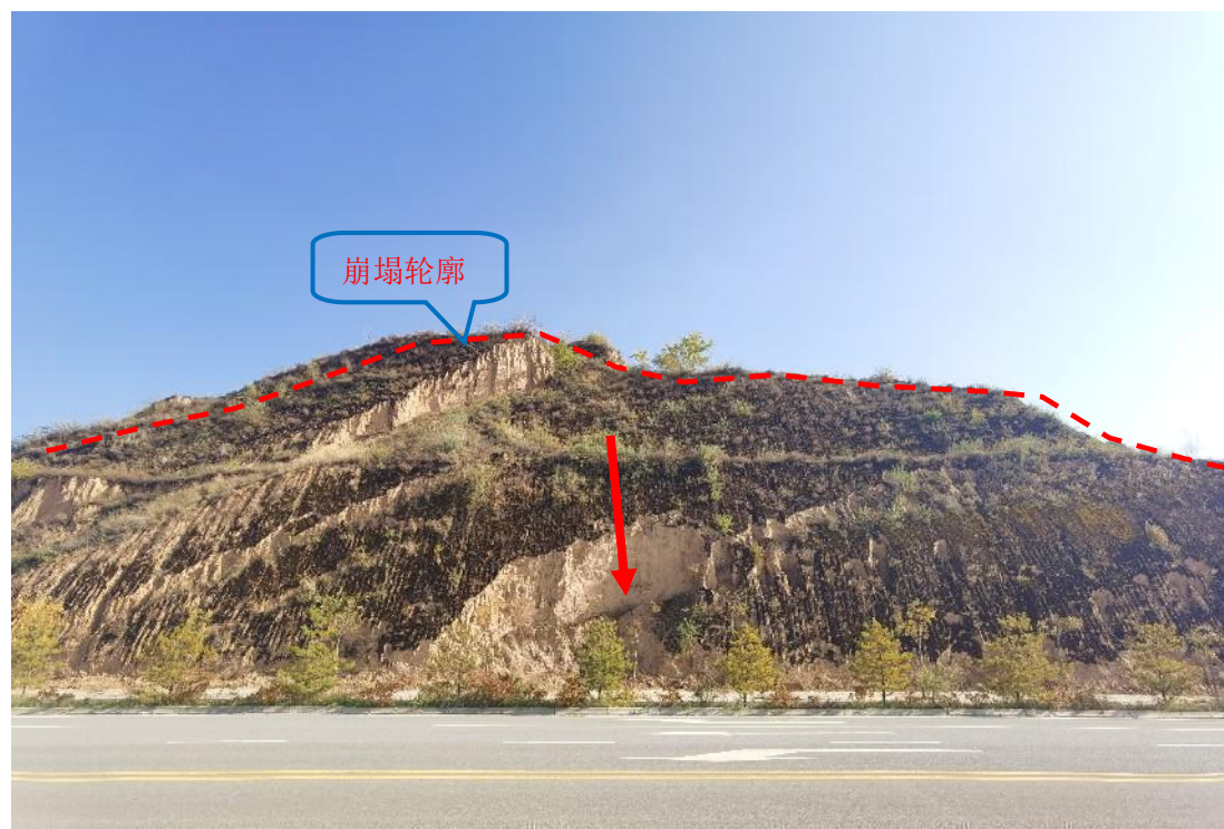
照片 4-7 BT7 崩塌（镜向 142°）
