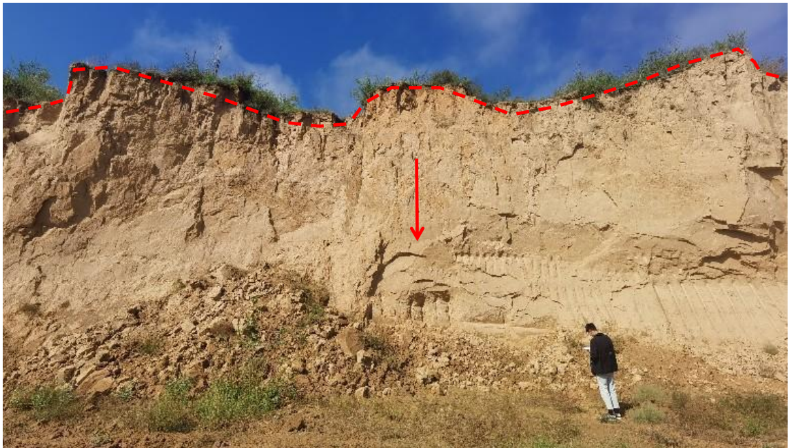
照片 4-2 BT2崩塌隐患（镜向258°）
