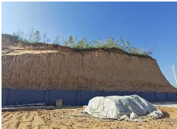
照片 4-3 BT3崩塌隐患（镜向265°）
