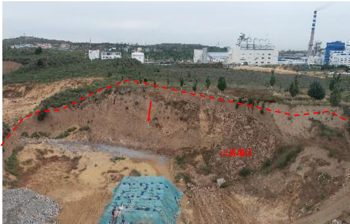
照片 4-4 BT4崩塌隐患（镜向15°）
