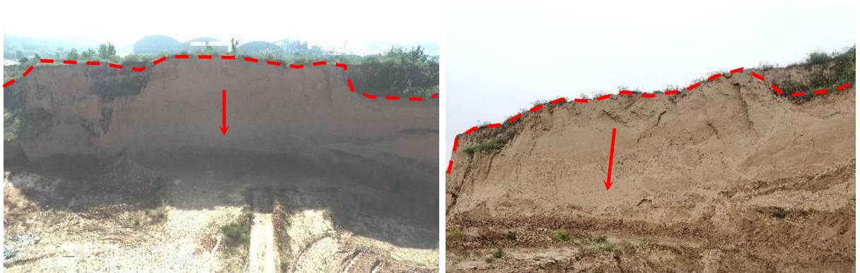
照片 4-6 BT6崩塌隐患（镜向131°）
