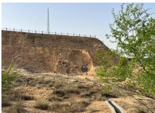
照片 3-23 填土边坡破坏（镜向 350°）
