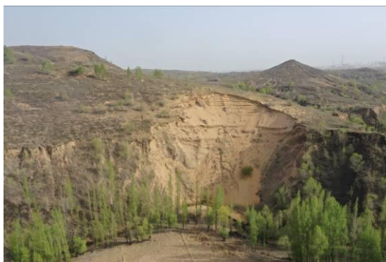
照片 3-10 沟坡崩塌（镜向 155°）
