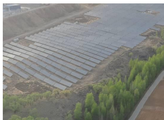
照片 3-24 光伏电板（镜向 310°）
