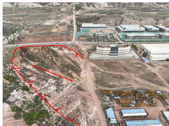
照片 4.2-54 BY04 崩塌隐患（镜向 310°）
