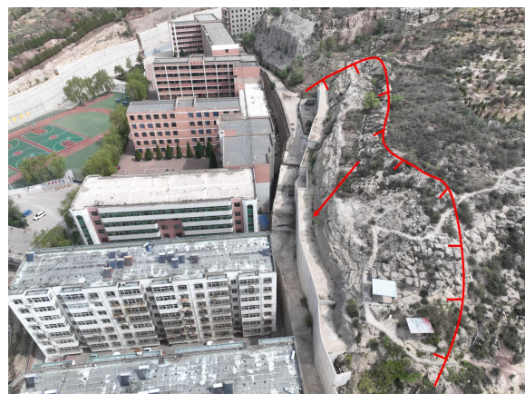
照片 4.2-86 BY19 崩塌隐患（镜向 30°）
