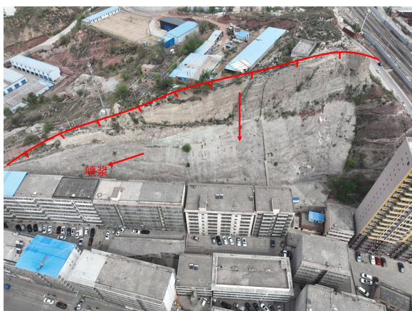
照片 4.2-25 B09 崩塌（镜向 335°）
