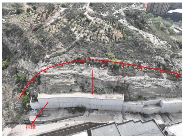
照片 4.2-85 BY19 崩塌隐患（镜向 105°）
