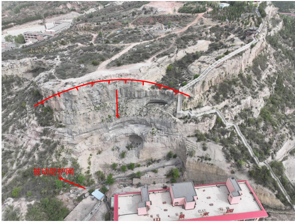
照片 4.2-37 B12 崩塌（镜向 225°）
