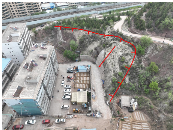
照片 4.2-30 B10 崩塌（镜向 90°）
