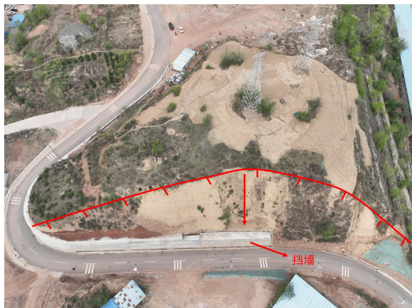
照片 4.2-21 B08 崩塌（镜向 310°）
