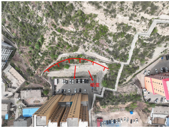
照片 4.2-81 BY17 崩塌隐患（镜向 300°）
