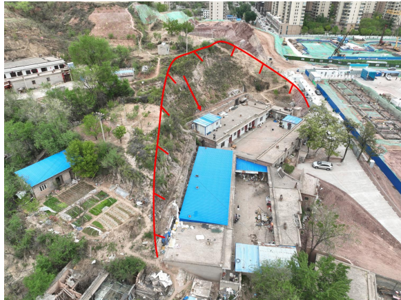
照片 4.2-90 BY21 崩塌隐患 (镜向 85°)
