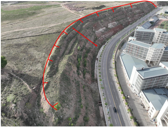
照片 4.2-49 BY02 崩塌隐患(镜向 15° )
