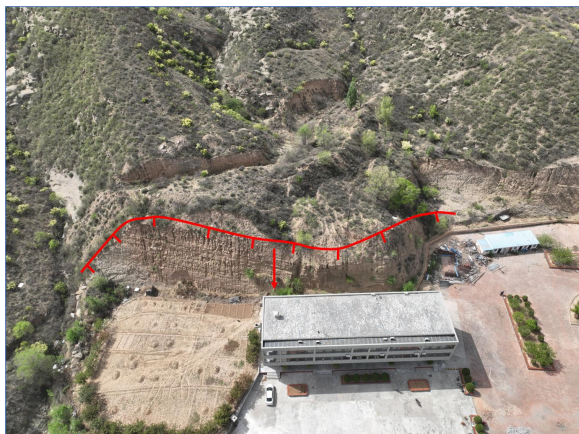
照片 4.2-47 BY01 崩塌隐患（镜向 300°）
