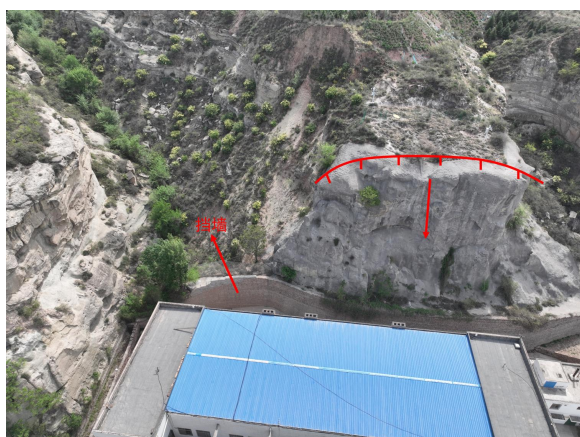
照片 4.2-41 B13 崩塌（镜向 110°）
