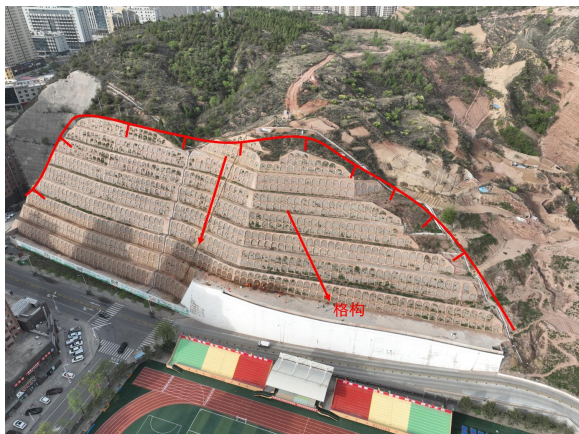
照片 4.2-9 B04 崩塌 (镜向 200°)
