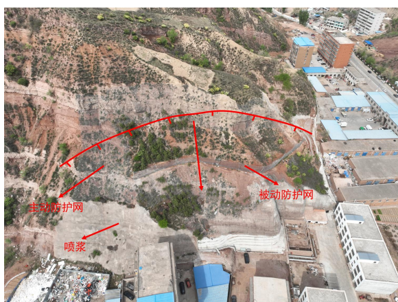
照片 4.2-17 B07 崩塌（镜向 250°）
