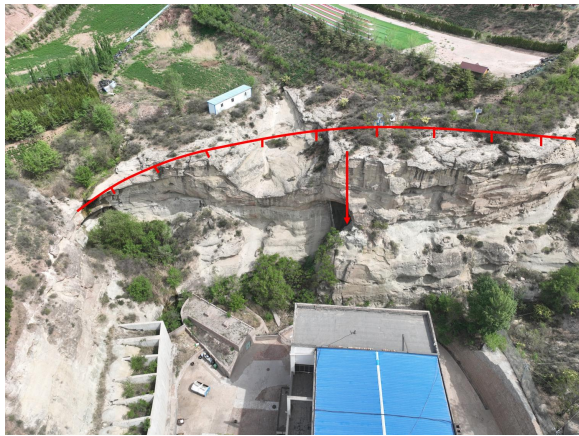
照片 4.2-83 BY18 崩塌隐患（镜向 30°）
