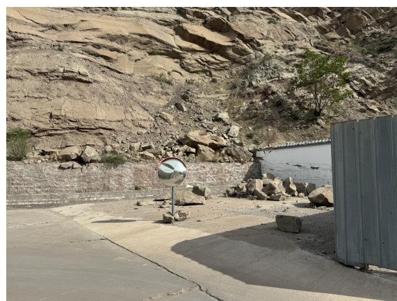
照片 4.2-12 B05 崩塌（镜向 25°）
