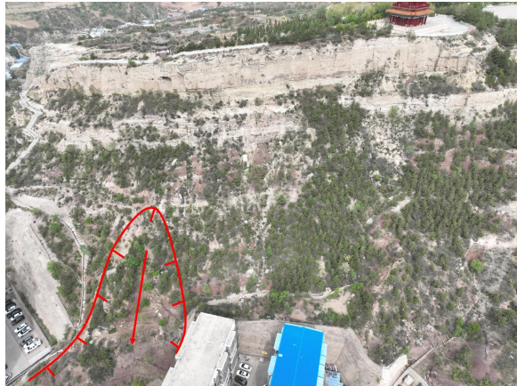
照片 4.2-80 BY16 崩塌隐患 (镜向 290°)
