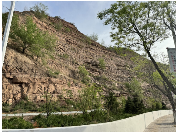
照片 4.2-8 B03 崩塌（镜向 30°）
