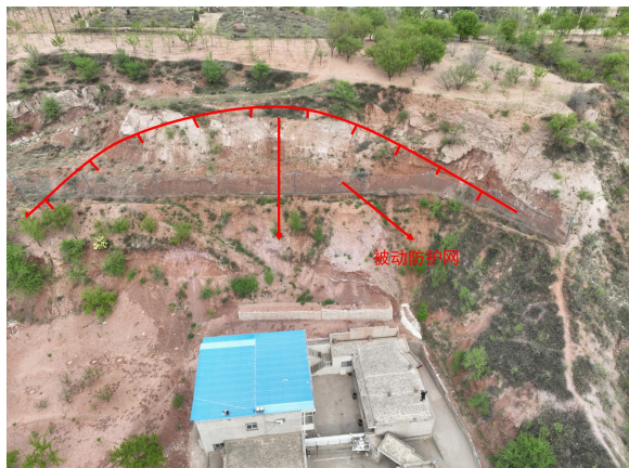
照片 4.2-43 B14 崩塌（镜向 65°）
