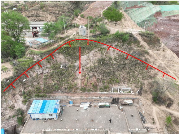
照片 4.2-89 BY21 崩塌隐患 (镜向 45°)
