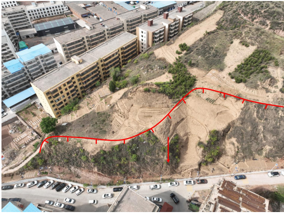
照片 4.2-57 BY06 崩塌隐患（镜向 210° ）
