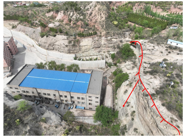
照片 4.2-84 BY18 崩塌隐患（镜向 290°）
