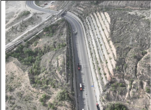
照片 4-10 B03 崩塌侧视航拍（镜像 340°）
