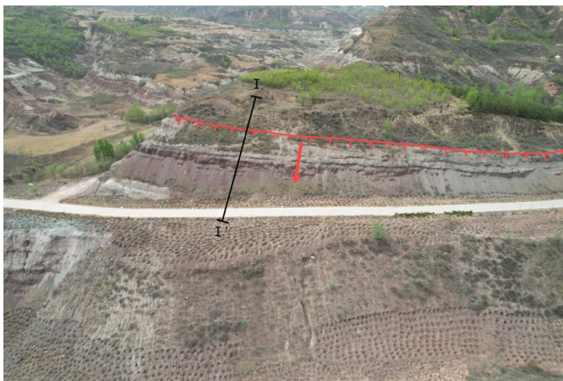
照片 4.2-4 崩塌隐患 BY03 全貌（镜向 225°）
