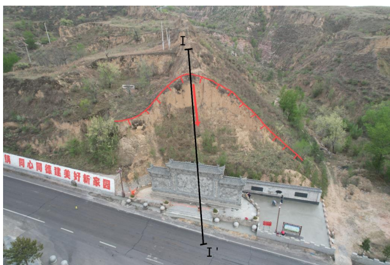
照片 4.2-1 崩塌 1 全貌（镜向 225^{\circ} ）
