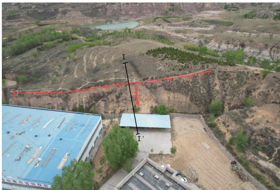
照片 4.2-6 崩塌隐患 BY05 全貌（镜向 320°）
