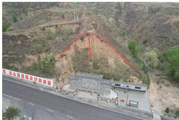
照片 4.1-1 崩塌 B01（镜向 225°）
