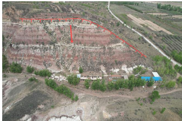
照片 4.1-5 崩塌隐患 BY04（镜向 315°）
