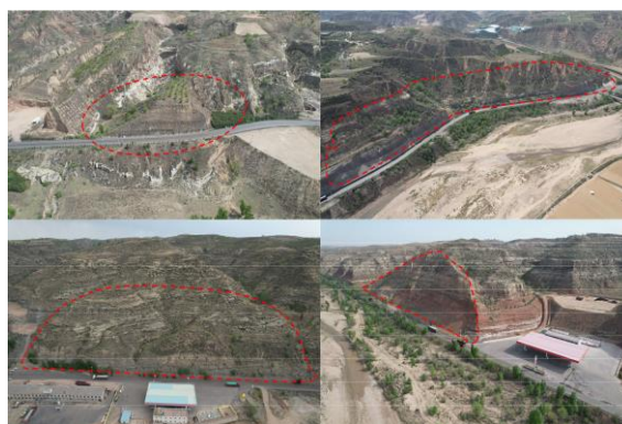
照片 3.8-6 道路建设造成的高边坡隐患
