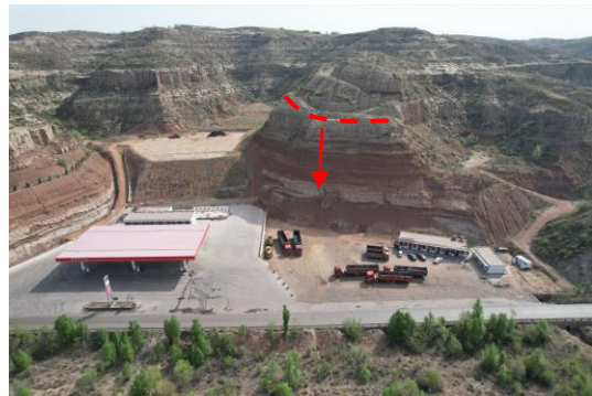
照片 4.1-2 崩塌 B02（镜向 70^{\circ} ） ——国华石油南侧崩塌
