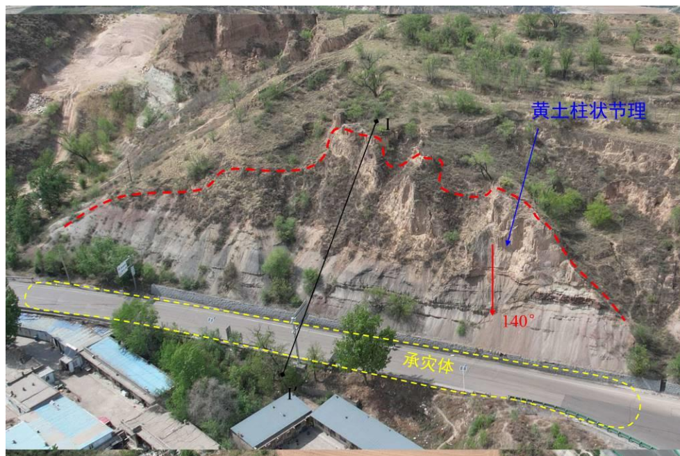
照片 4.2-20 崩塌 B20（镜向 290^{\circ} ）——川根底公路边崩塌
