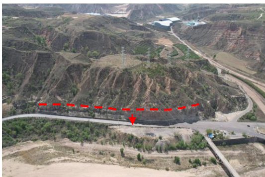
照片 4.1-19 崩塌 B19（镜向 220°） ——魏寨清水川大桥西侧公路崩塌
