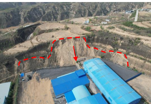
照片 4.1-30 滑坡 H01（镜向 210°） ——宝恒洗选煤厂后滑坡
