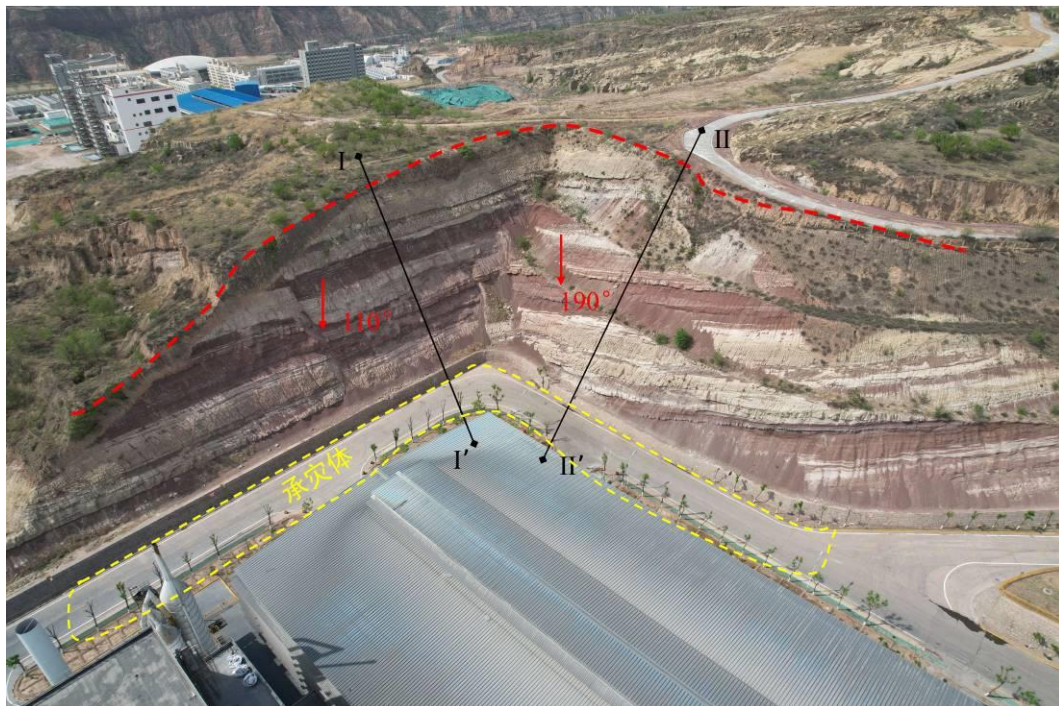
照片 4.2-22 崩塌 B22（镜向 330^{\circ} ）——新元洁能东南侧场地西北角崩塌
