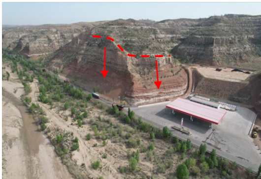
照片 4.1-1 崩塌 B01（镜向 10^{\circ} ） ——国华石油北侧崩塌
