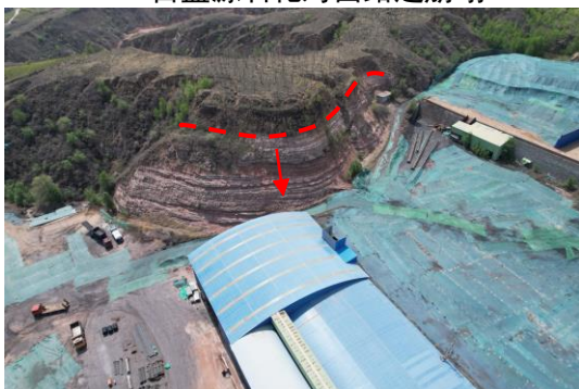
照片 4.1-17 崩塌 B17（镜向 200°） ——恒基有限公司西南侧厂房崩塌
