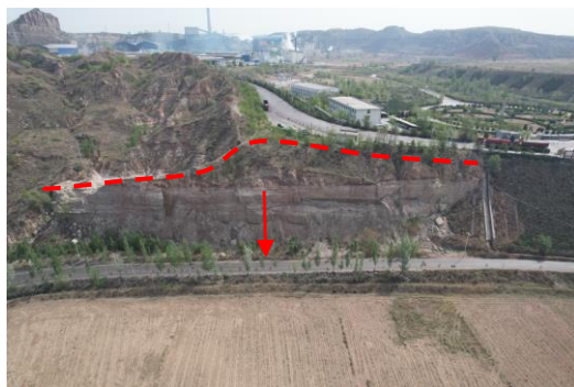
照片 4.1-16 崩塌 B16（镜向 80°） ——府谷镁业集团有限公司门口公路崩塌
