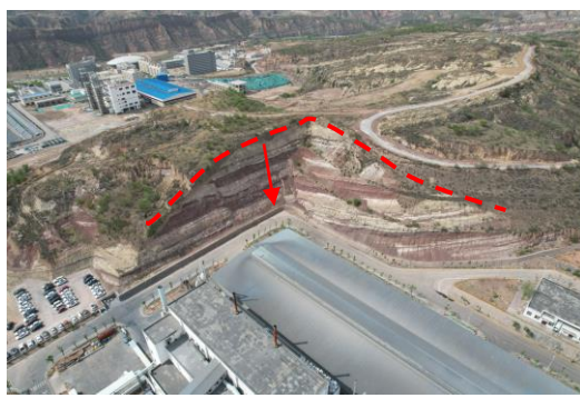
照片 4.1-22 崩塌 B22（镜向 330°） ——新元洁能东南侧场地西北角崩塌
