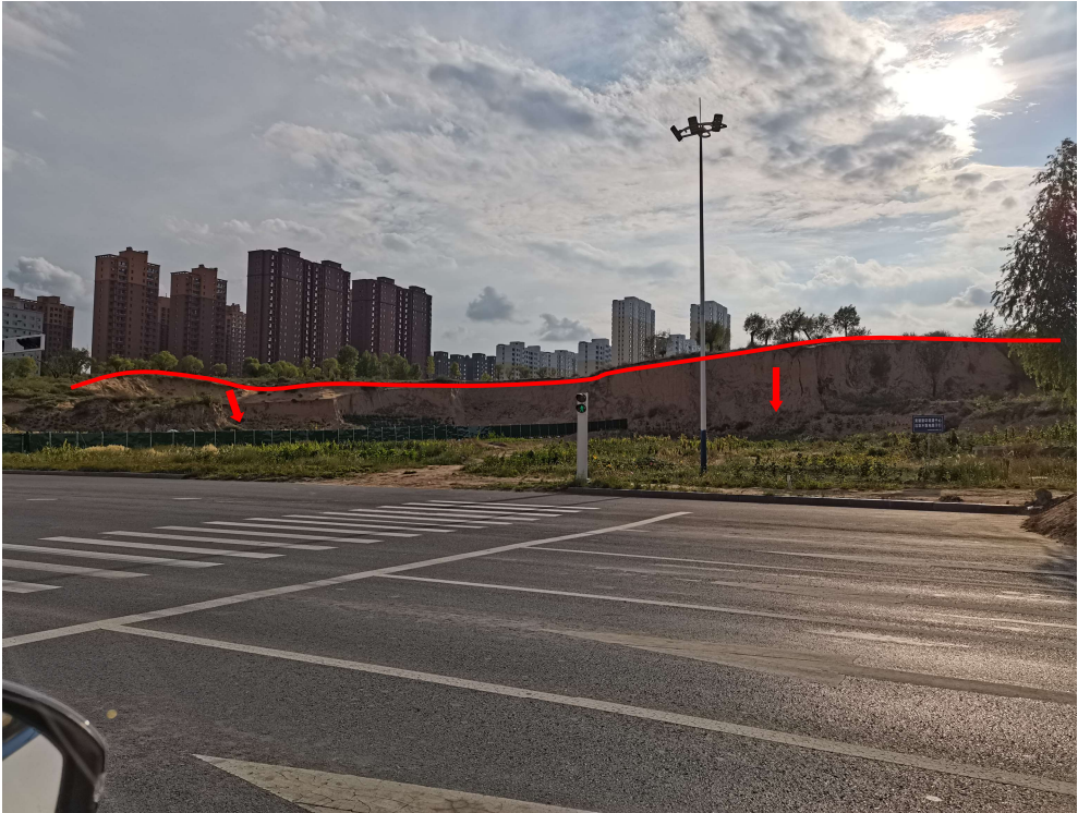
照片 3-2 B 5 崩塌局部 镜向 250°
