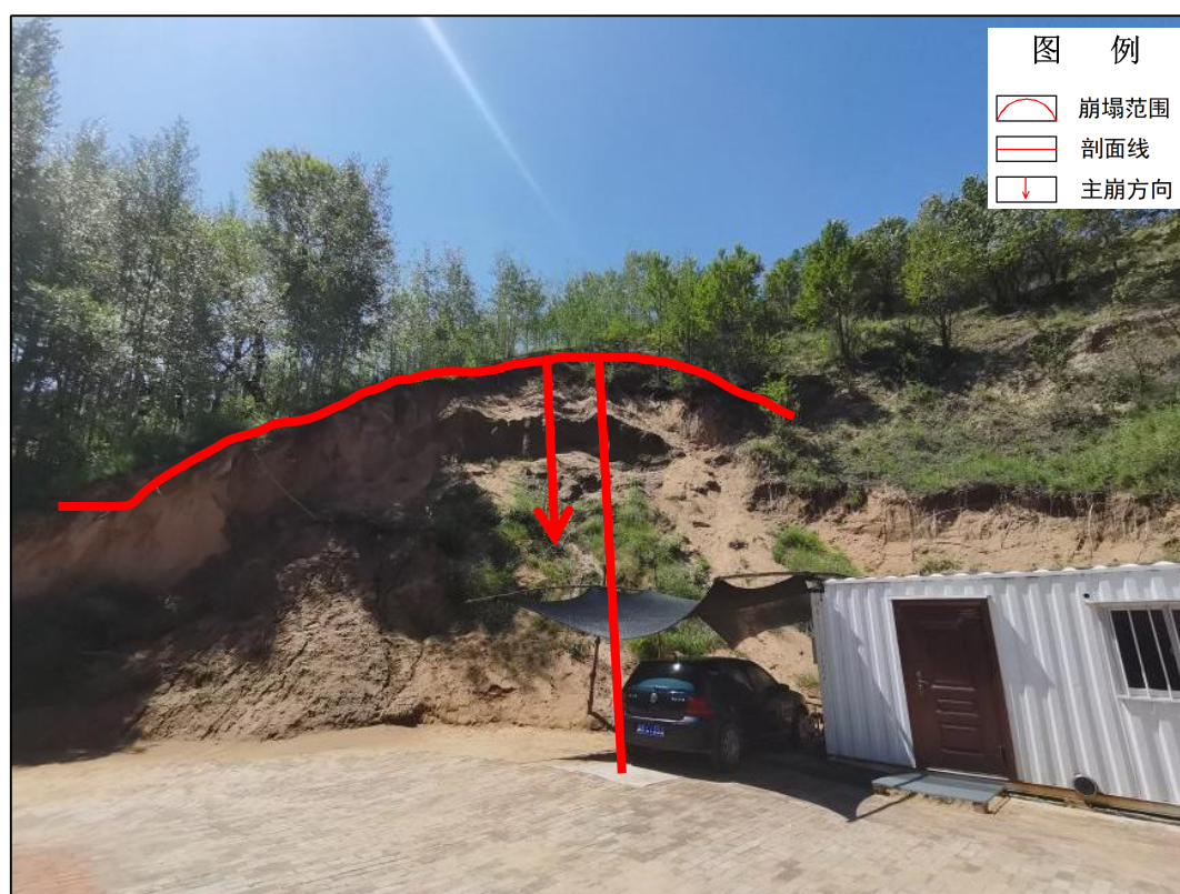
照片 3-1 新开沟 1 号崩塌（B1）全貌图（镜向 165°）
