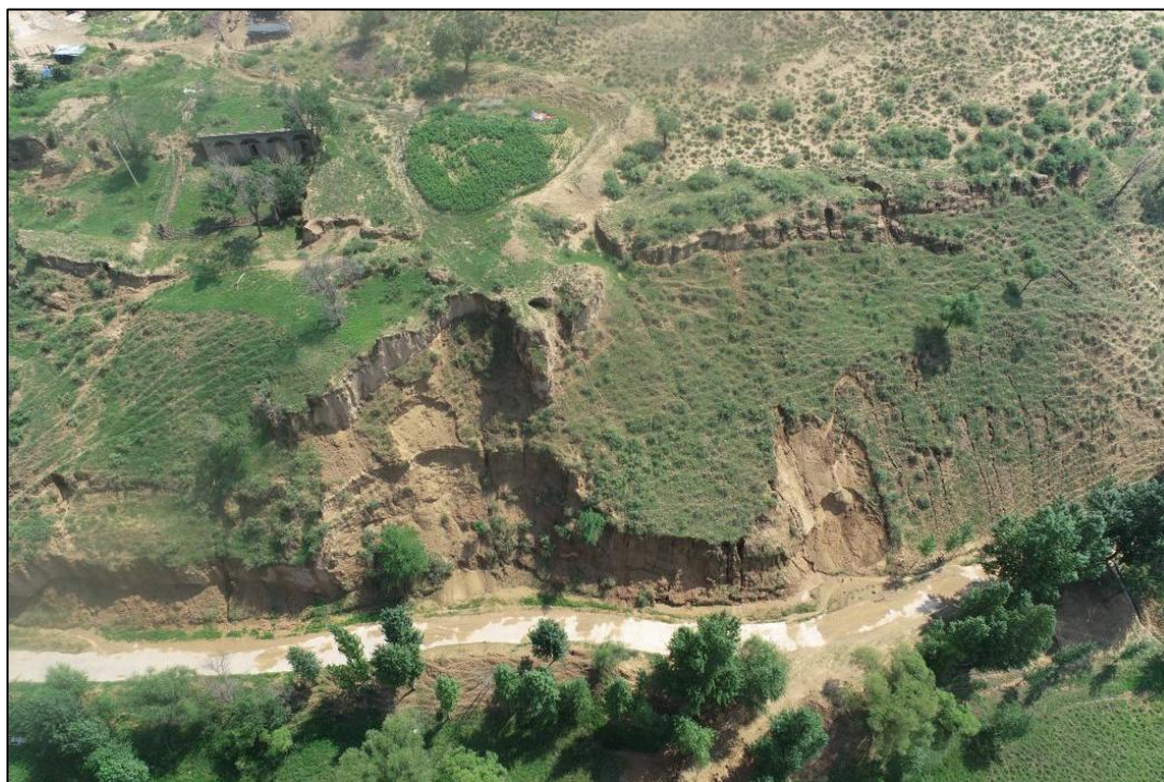
照片 3-9 方河沟不稳定斜坡（XP4）变形区航拍图（镜向 93°）
